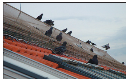
▲ Obr. 15 ● Proti hnízdícím holubům musely být kolektory překryty sítí
