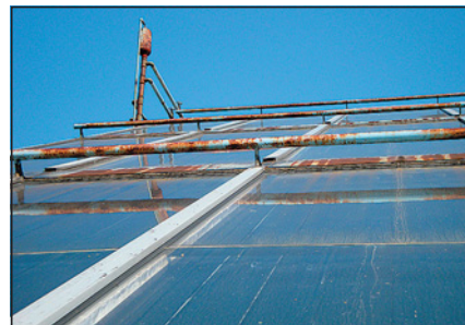
▲ Obr. 4 ● Stékající rezavé čmouhy snižovaly vstup slunečního záření
