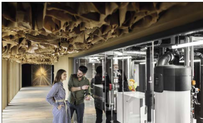
▲ Obr. 1 ● V Sonnentoru jsou tepelná čerpadla součástí prohlídkové trasy
