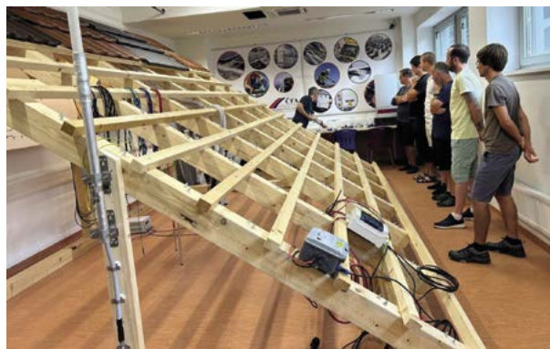
▲ Obr. 1 ● Učebna slouží studentům k tréninku instalace FV střešních systémů, autor: Archiv FEKT a archiv ČFA
