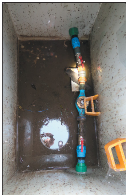
▲ Obr. 1 ● Vodoměrná šachta
