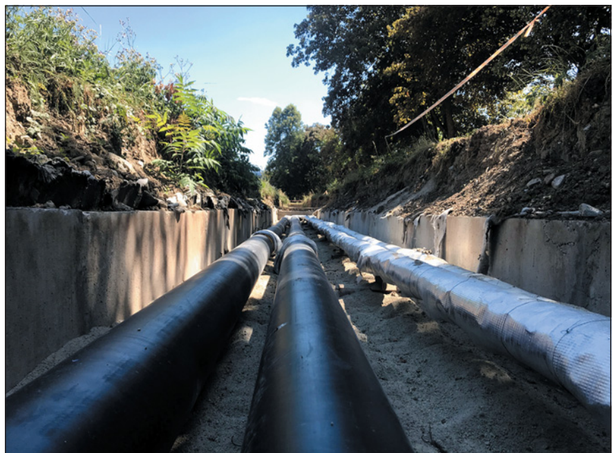
▼ Obr. 2 ● Ukázka teplovodního kanálu – dosluhující potrubí TV a cirkulace a nové ocelové předizolované potrubí na hlavní trase
