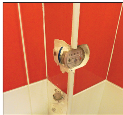
▲ Obr. 23 ● Zazděný vodoměr
