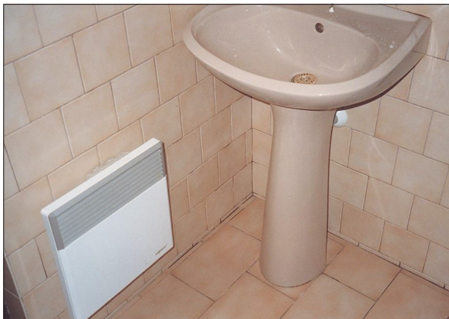
▲ Obr. 5 ● Elektrické topidlo umístěné v malé koupelně v podkroví
