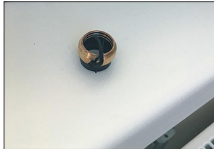
▲ Obr. 3 ● Na parapetu okna je vidět vyložený těsnicí kroužek šroubení VK
