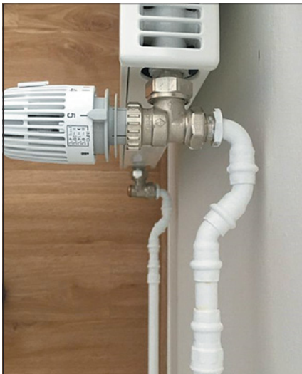
▲ Obr. 1 ● Boční napojení otopného tělesa Radik lisovanou mědí – poněkud to připomíná napojování kanalizačního potrubí
