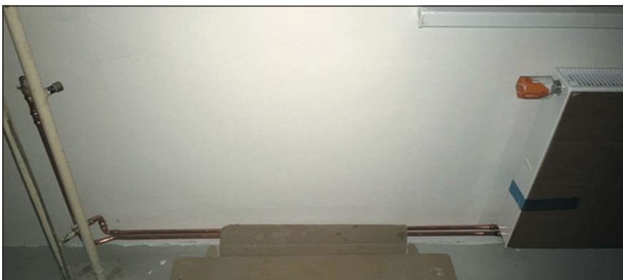
▼ Obr. 2 ● Odbočení ze stoupačky pro těleso Radik VK – přívod i zpětné měděné potrubí klesá k podlaze a napojuje spodem otopné těleso
