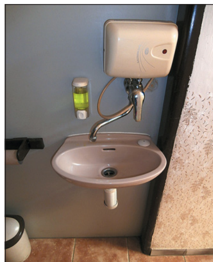
▼ Obr. 16 ● Přívodní elektrický kabel trčí do umývacího prostoru umyvadla
