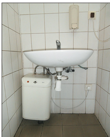
▲ Obr. 18 ● Ohřívač není připevněn ke stavební konstrukci, leží šikmo na dřevěném špalku položeném na podlaze
