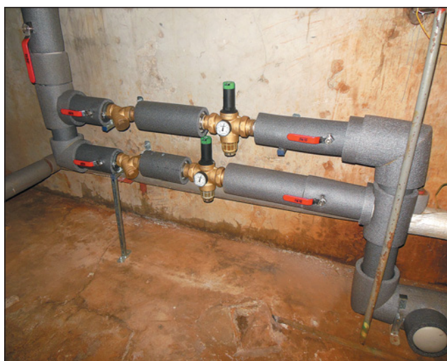
◀ Obr. 4 ● Paralelní osazení redukčních ventilů včetně uzávěrů a mechanických filtrů v potrubí za vodovodní přípojkou velkého bytového domu (voda proudí současně oběma redukčními ventily)
