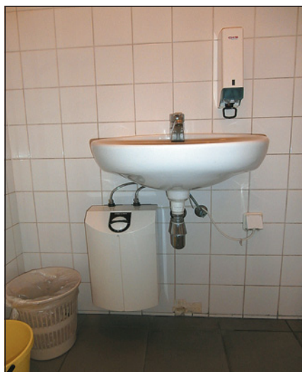
▼ Obr. 19 ● Elektrická zásuvka je umístěna v kratší vzdálenosti než připouští norma (200 mm od hrany umyvadla)
