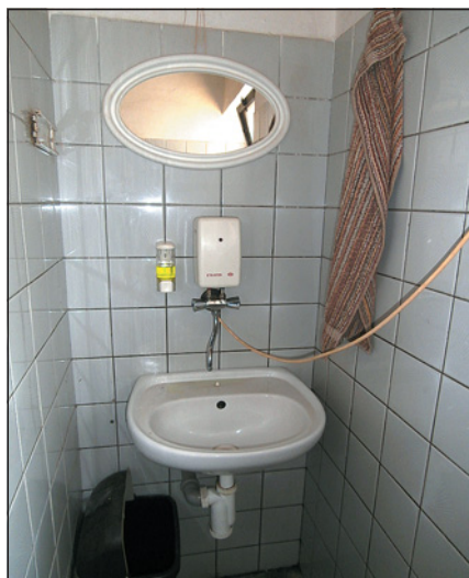
▲ Obr. 17 ● Přívodní elektrický kabel je volně veden přes celou délku místnosti a překáží
