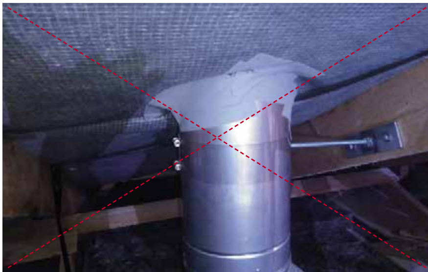
▲ Obr. 2 ● Chybné provedení napojení parozábrany na třívrstvý nerezový komín
