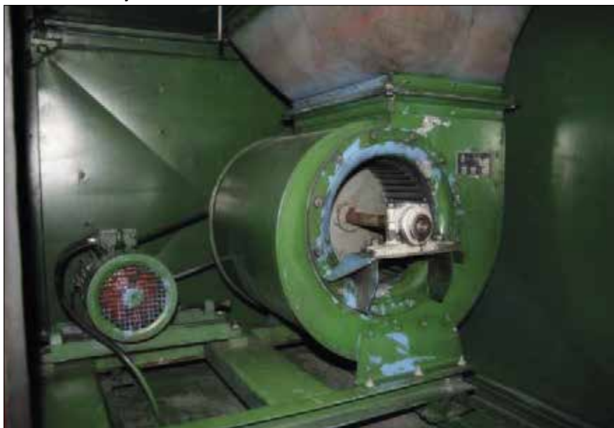
▼ Obr. 9 ● VZT jednotka č. 12 z roku 1980
