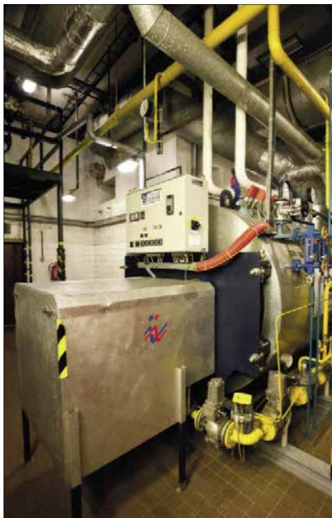
▲ Obr. 2 ● Parní kotel LOOS Dampfix 1000 včetně napájecího čerpadla, výkon Q = 1 \text{ t} \cdot \text{h}^{-1} , přetlak 400 až 600 kPa (pára se používala jednak pro vlhčení vzduchu v klimatizačních zařízeních, jednak v kuchyni restaurační budovy)
