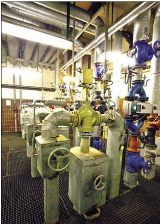
▲ Obr. 3 ● Směšovací zařízení jednotlivých okruhů zařízení techniky prostředí (pod roštovou podlahou je umístěn základní Tichelmannův okruh, na nějž jsou jednotlivé výše popsané okruhy připojeny)
