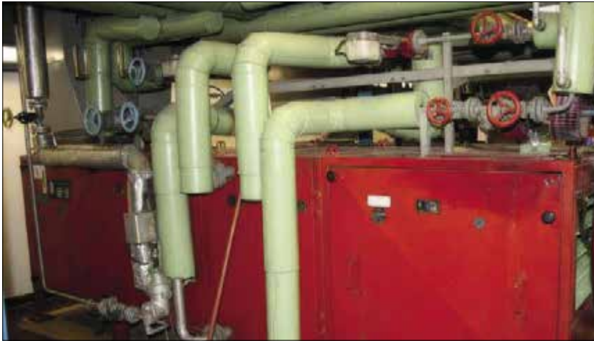
▲ Obr. 10 ● VZT jednotka č. 5 z roku 1980
