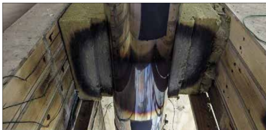
▼ Obr. 4 ● Fotodokumentace minerální izolace a nerezového komínového systému po provedení zkoušky na vyhoření sazí – zbarvená tepelná izolace dokládá vysoké teplotní zatížení
