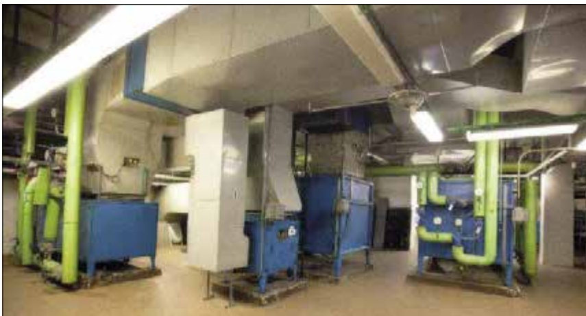
▲ Obr. 11 ● Strojovna VZT č. 2
