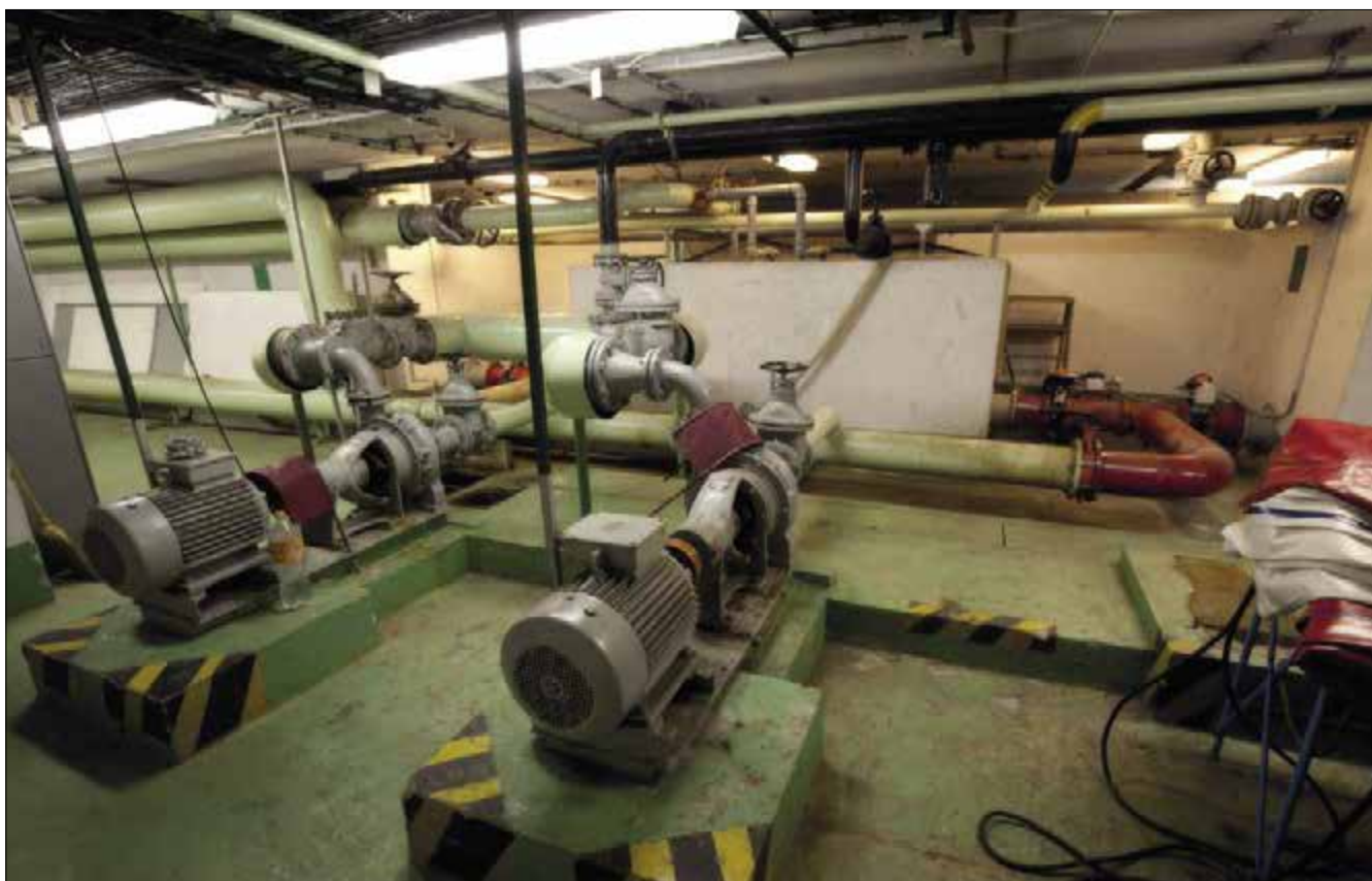
▼ Obr. 5 ● Nádrž požární vody + čerpadla
