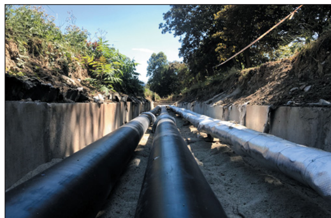
▼ Obr. 2 ● Ukázka teplovodního kanálu – dosluhující potrubí TV a cirkulace a nové ocelové předizolované potrubí na hlavní trase
