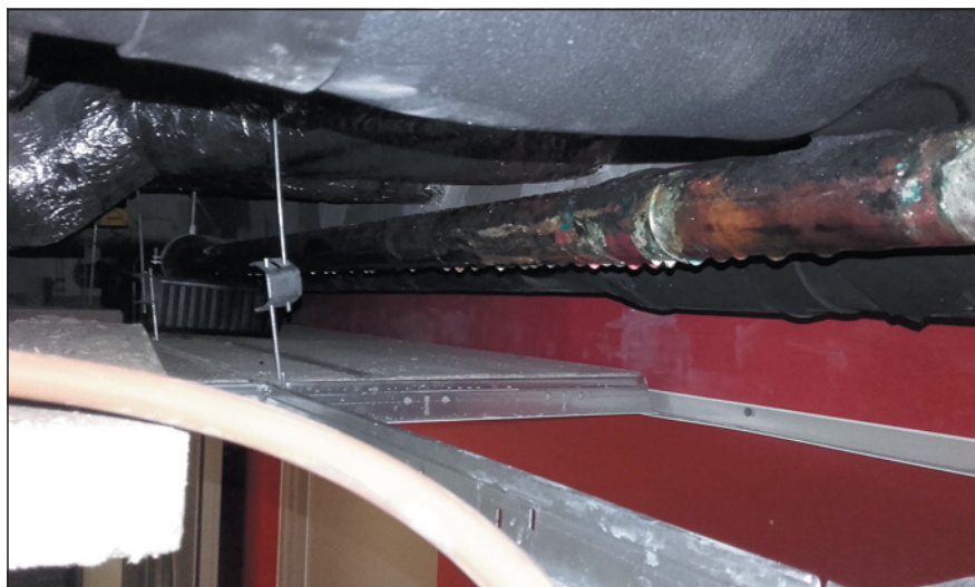
▲ Obr. 2 ● Měděné potrubí chladicí soustavy nebylo místy opatřeno parotěsnou tepelnou izolací. Docházelo ke kondenzaci par
