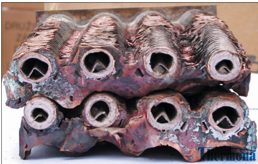
▲ Obr. 3 ● Výměník atmosférického kotle, jehož trubková část byla silně zanesena vodním kamenem a usazeninami, které zcela znemožnily přenos tepla do otopné vody. Následně došlo k přehřátí a deformaci celého výměníku
