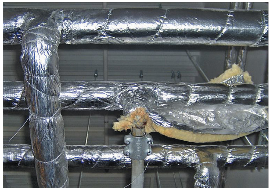
▼ Obr. 4 ● „Cípant“ na ocelovém pozinkovaném potrubí
