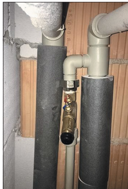
▼ Obr. 2 ● Termoregulační uzávěr v bytě v nejvyšším podlaží
