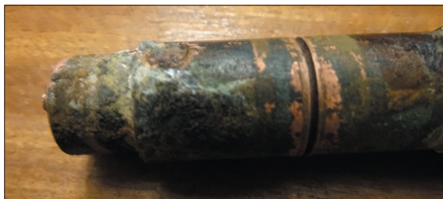
▼ Obr. 3 ● Koroze vnější části měděného potrubí vyjmutého při opravě
