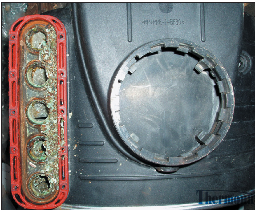
▼ Obr. 1 ● Výměník kondenzačního kotle zanesený nečistotami z otopné vody
