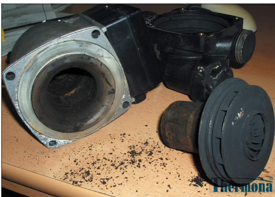
▲ Obr. 4 ● Oběhové čerpadlo zanesené kalovými nečistotami z otopné soustavy. Vlivem usazování nečistot došlo k zadření kluzných ložisek čerpadla
