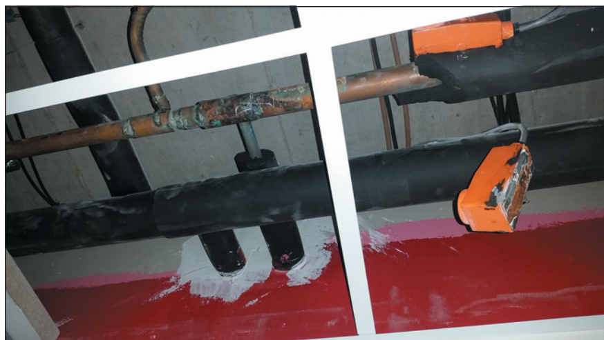
▼ Obr. 1 ● Zkorodovaná zinková podložka termostatu a původní umístění termostatu
