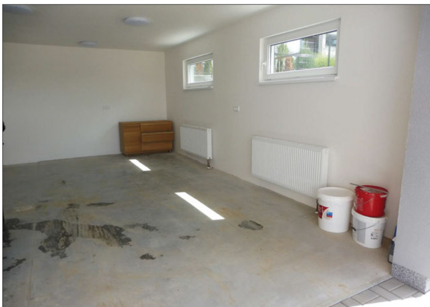
▼ Obr. 27 ● Desková otopná tělesa v garáži (zdroj: autor)
