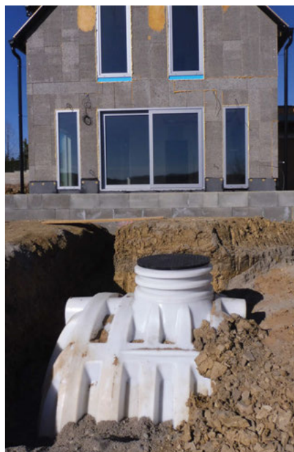
▲ Obr. 31 ● Podzemní akumulaciční nádrž na dešťovou vodu o objemu 5 m 3 pro popisovanou dřevostavbu (zdroj: autor)
