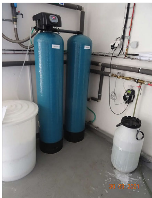
▼ Obr. 1 ● Demineralizační úpravna vody
