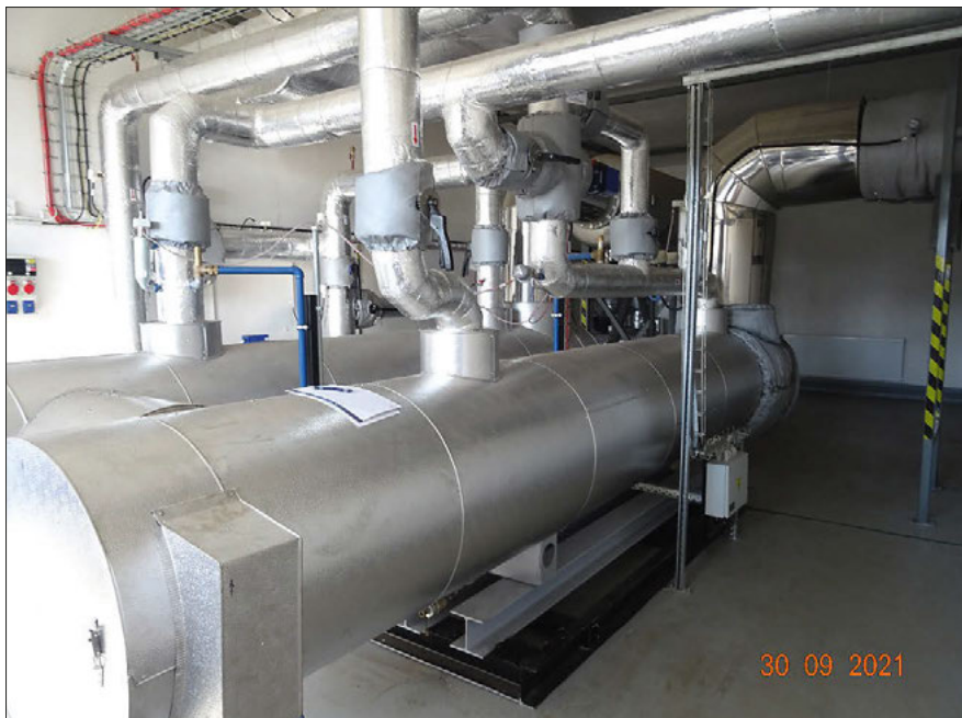
▲ Obr. 2 ● Přední výměník tepla byl poškozen korozi
