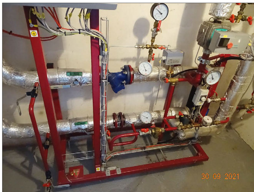
▼ Obr. 3 ● Tlakově nezávislá výměníková stanice připojená k otopné soustavě
