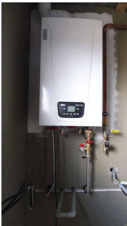
▲ Obr. 28 ● Plynový kondenzační kombi kotel částečně zapojený (zdroj: autor)
