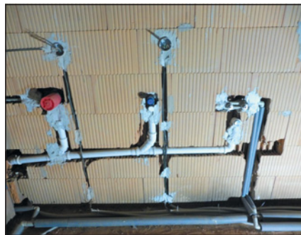
▲ Obr. 17 ● Instalace vodovodu a kanalizace v podkroví, vodovodní potrubí je nedostatečně tepelně izolováno a vedeno nevhodně v podlaze
