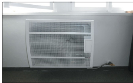
▲ Obr. 22 ● Připojení plynového topidla na plynovodní potrubí flexibilní trubicí
