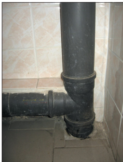
▲ Obr. 20 ● Napojení připojovacího potrubí na odpadní potrubí odbočkou s úhlem 87,5°, kdy je nutné převýšení připojovacího potrubí, kuriózní je vedení potrubí před obkladem
