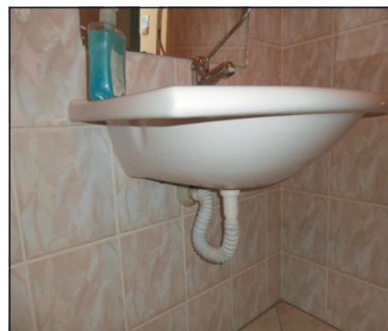
▲ Obr. 19 ● Sporné připojení zařizovacího předmětu na potrubí vnitřní kanalizace flexibilní trubkou nahrazující zápachovou uzávěrku
