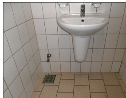
▲ Obr. 15 ● Podlahová vpust umístěná pod výtokovou armaturou v blízkosti umyvadla na WC
