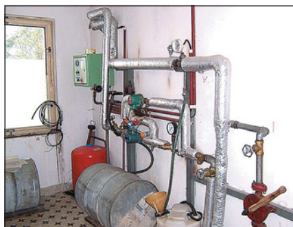
▲ Obr. 11 ● První kusové solární dodávky „se vším všudy“, montáž se prováděla až na místě
